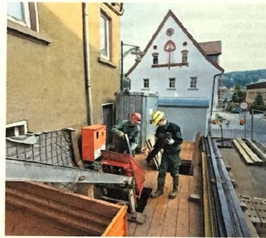
Vor diesem Haus an der Gottesacker-gasse (im Foto Karl-Wilhelm Preißner, links, und Azubi Andreas Illing) gab die Erde nach.
